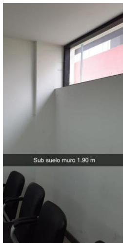
Figura 40. Irregularidad en elevación-Columna Corta
