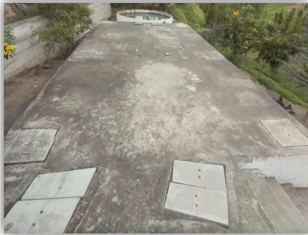
Figura 7: Tanque de sedimentación primaria
