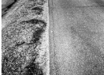
Imagen N° 8: Fisura de borde
