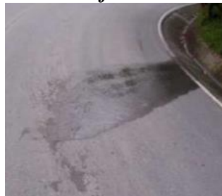
Imagen N° 24: Afloramiento de agua
