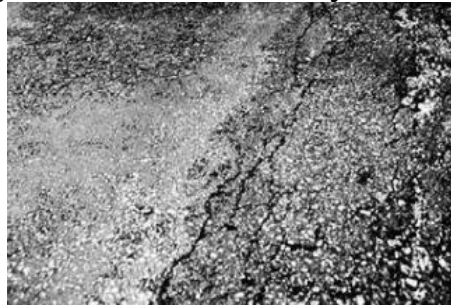
Imagen N° 13: Abultamiento y hundimiento
