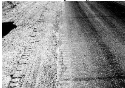
Imagen N° 9: Fisura por reflexión de junta
