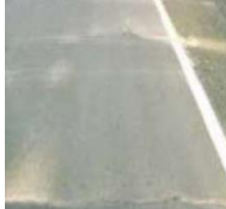
Imagen N° 23: Afloramiento de finos
