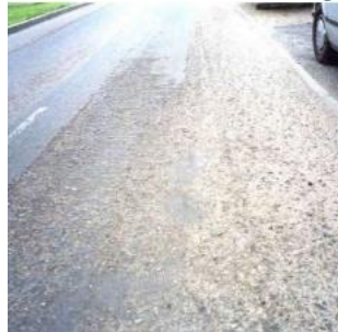
Imagen N° 18: Perdida de agregado
