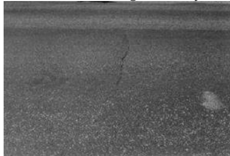
Imagen N°10: Fisura longitudinal y transversal
