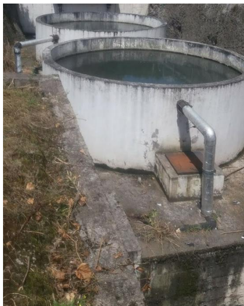
Figura 17: Tanque séptico (PTAR).
