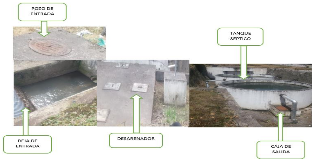
Figura 35: Estado actual de la planta de tratamiento de la parroquia San Andrés
