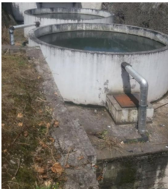
Figura 40: Tanque séptico (PTAR).
