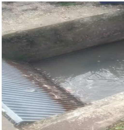
Figura 39: Reja de entrada (PTAR).
