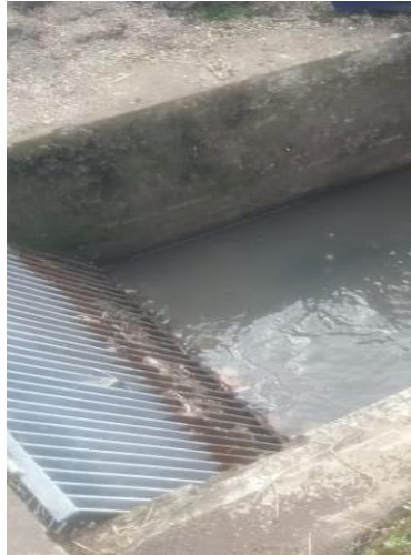
Figura 15: Reja de entrada (PTAR).
