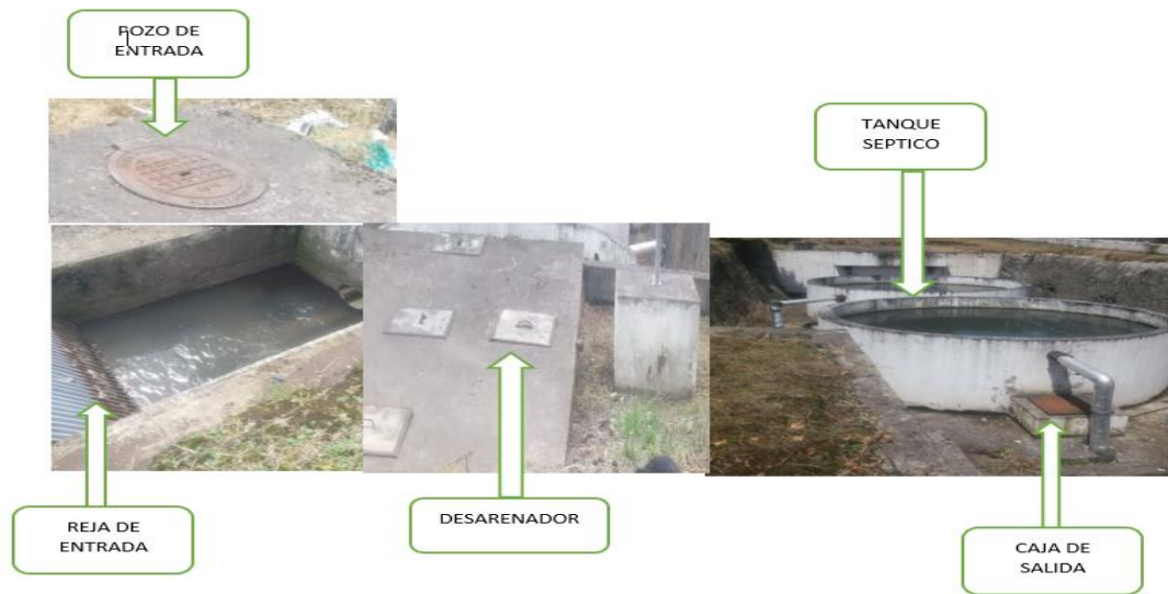
Figura 13: Estado actual de la planta de tratamiento de la parroquia San Andrés (PTAR).
