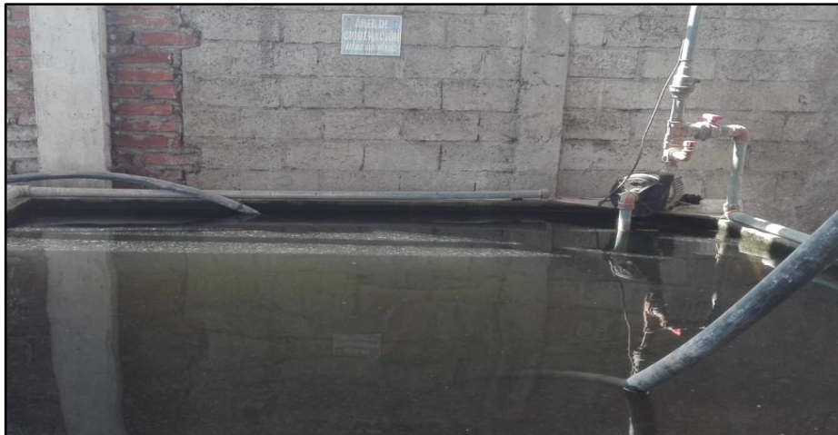
Figura 24. Tanques de oxigenación de aguas residuales.
