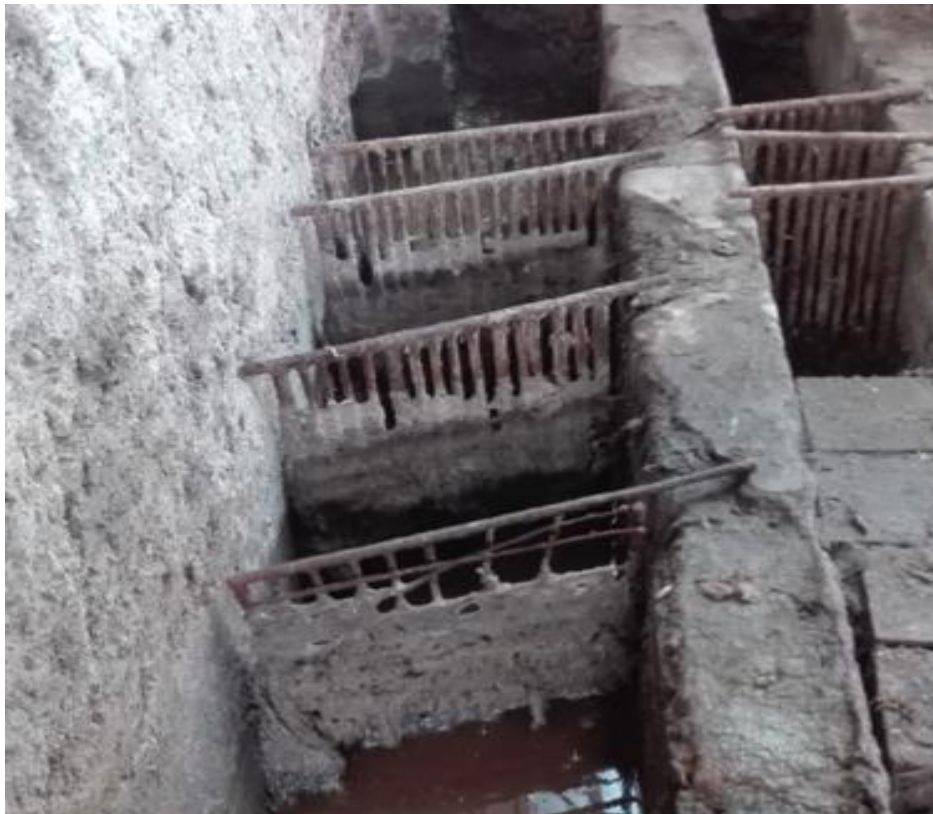
Figura 28. Rejillas para retener los efluentes sólidos.
