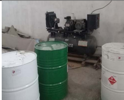
Almacenamiento de productos químicos junto a la unidad de aire comprimido
