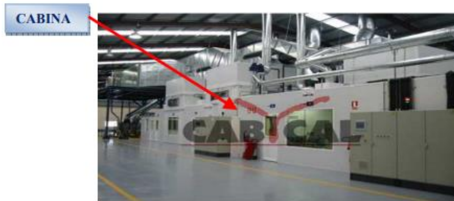
Figura 1. Cabina de pintura Cabycal [9].
