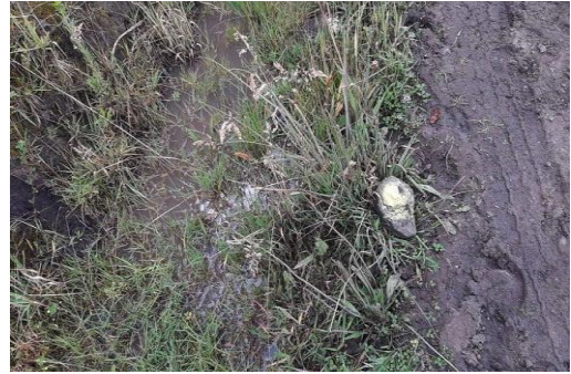
Anexo H-2. Acumulación de agua en el extremo de la vía.
