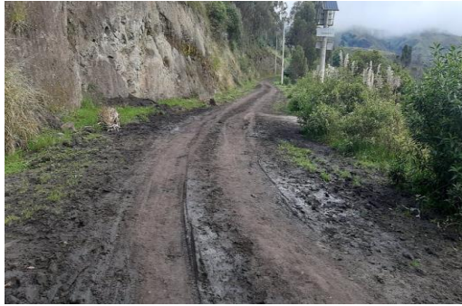
Anexo H-1. Estado de la vía.
