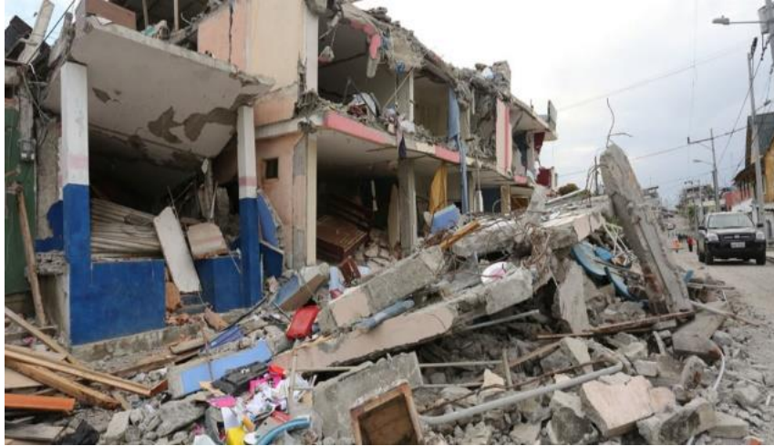
Imagen 5 Terremoto 16 de Abril 2016
