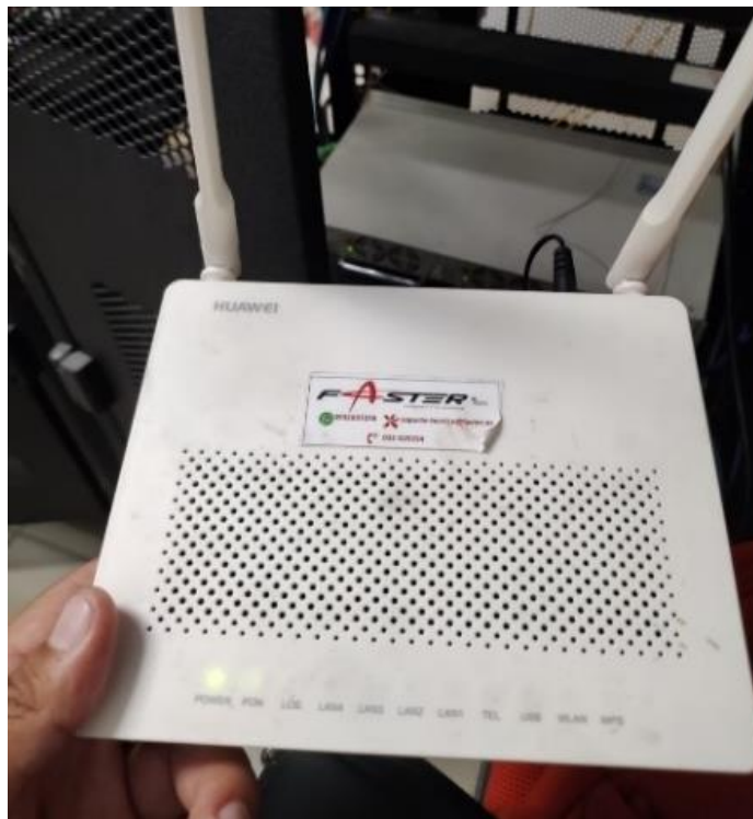
Figura 4.4 Instalación en cliente final
