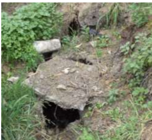
Figura 20 Pozo de salida actual de la PTAR.
