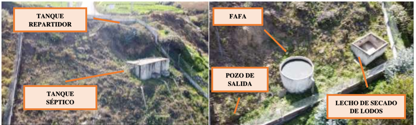
Figura 14 Estado actual de los componentes de la PTAR de la comunidad de Llimpe Grande.
