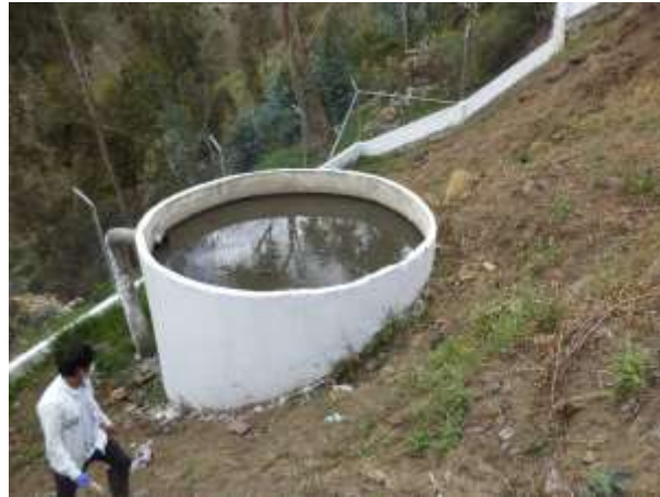
Figura 18 Flujo Anaerobio de Flujo Ascendente actual de la PTAR..
