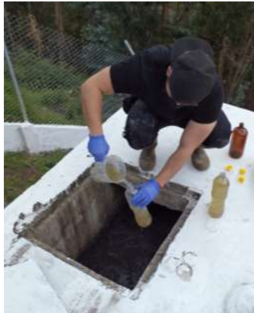
Figura 11 Toma de muestra del agua residual que ingresa a la planta de tratamiento.
