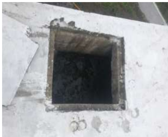
Figura 17 Tanque séptico actual de la PTAR.
