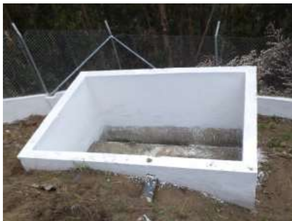
Figura 19 Lecho de secado de lodos de la PTAR
