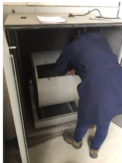
Limpieza interior del equipo
