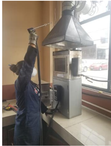
Gráfico 12 Instalación de equipo FYRITE INSIGHT PLUS
