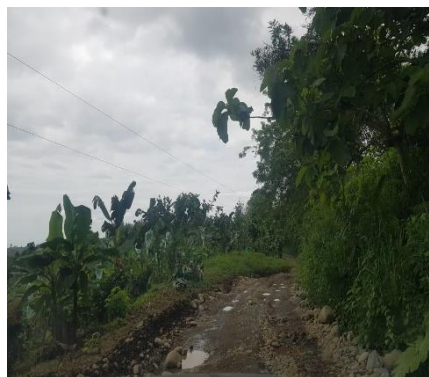
Figura. 25 Estado de la vía – Época de Invierno
