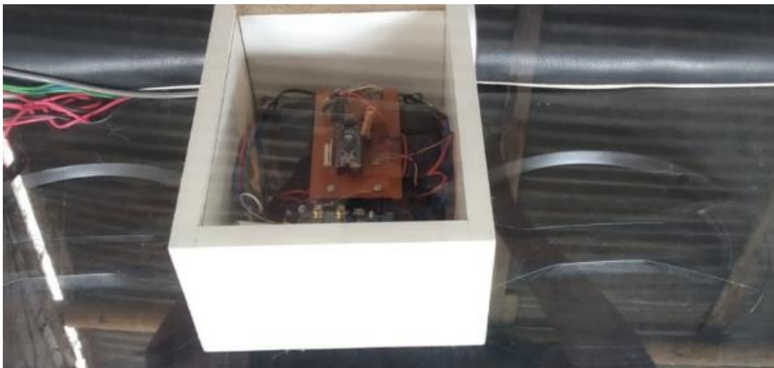
Figura N°56: Vista Externa Sistema de Seguridad
