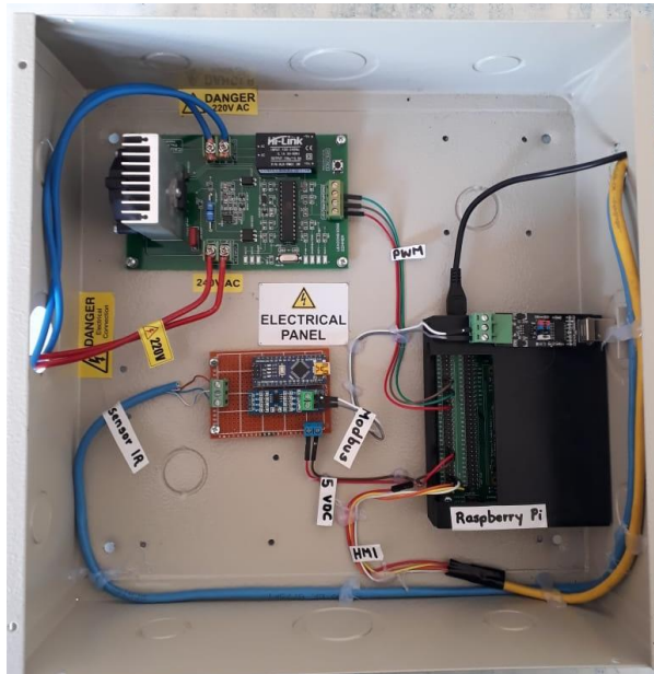
Fig.3. 37: Montaje del sistema de control Elaborado por: Investigador
