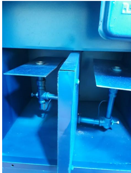
Ilustración 5. Cámara de reactivación de suelas
