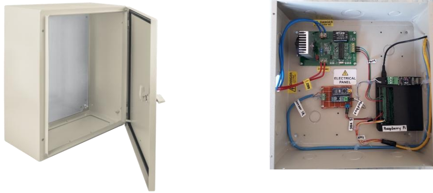
Ilustración 2. Caja de protección eléctrica
