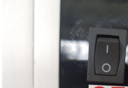
Figura 82. Interruptor de la fuente de alta tensión. Fuente: [Autor]
