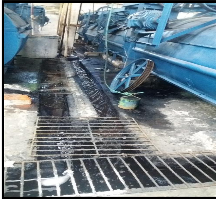
Figura 19. Canales para aguas residuales provenientes de las máquinas y canal hacia tanque de tratamiento.
