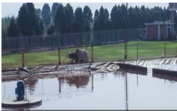
Figura 6. Mezclador de aguas industriales
