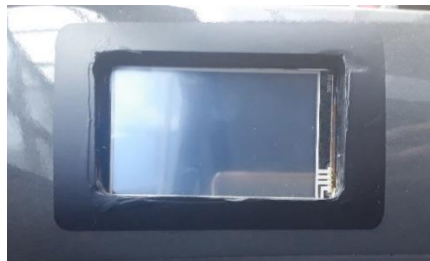
Figura 4.30 Implementación de las Interfaz HMI en el tablero
