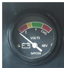
Figura 4.31 Medidor de Voltaje en el tablero
