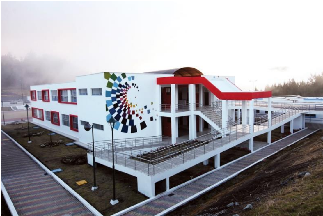
Ilustración 1 UNIDAD EDUCATIVA DEL MILENIO EN PROCESO DE CONSTRUCCIÓN Fuente: Presidencia de la República del Ecuador
