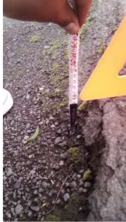
Desnivel del carril/berma
