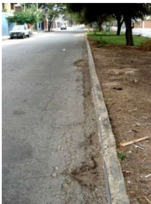
Figura 33: Grieta de borde
