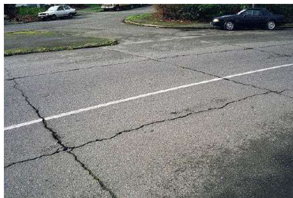
Figura 34: Grieta de reflexión de junta
