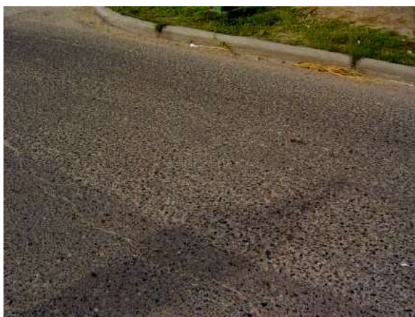
Figura 44: Meteorización o desprendimiento de agregados
