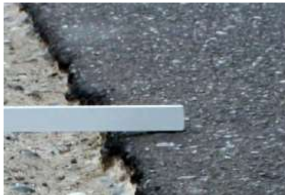
Figura 35: Desnivel del carril/berma
