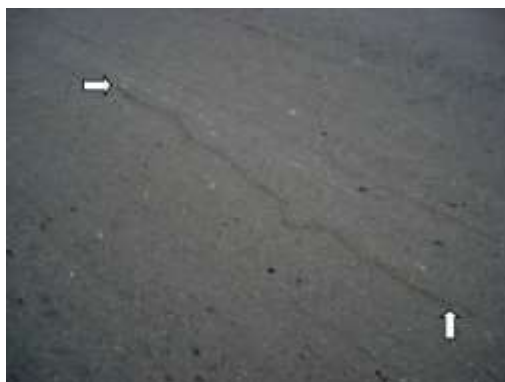
Figura 36: Grietas longitudinales y transversales
