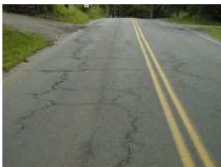
Figura 29: Fisuras o grietas en bloque
