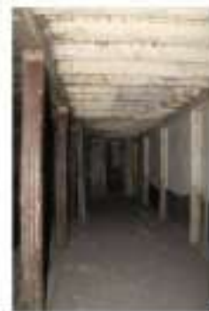
Originalmente no existía cielo falso, solo se observaba el entablado de maderas.
