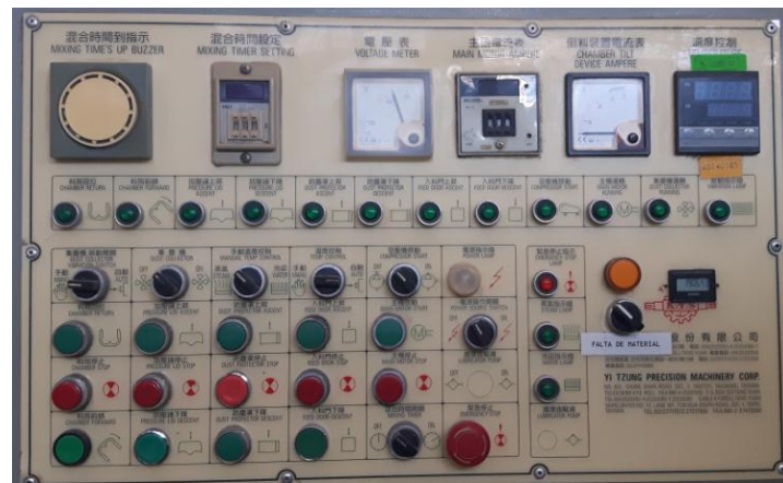
Fig. N° 17: Botoneras, luces piloto y controles electromecánicos Fuente: Mezcladora YT04
