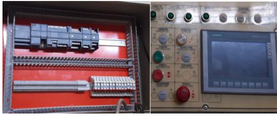
Fig. N° 31: Instalación de fuente, PLC, módulos y HMI Fuente: Automatización de mezcladora YT04
