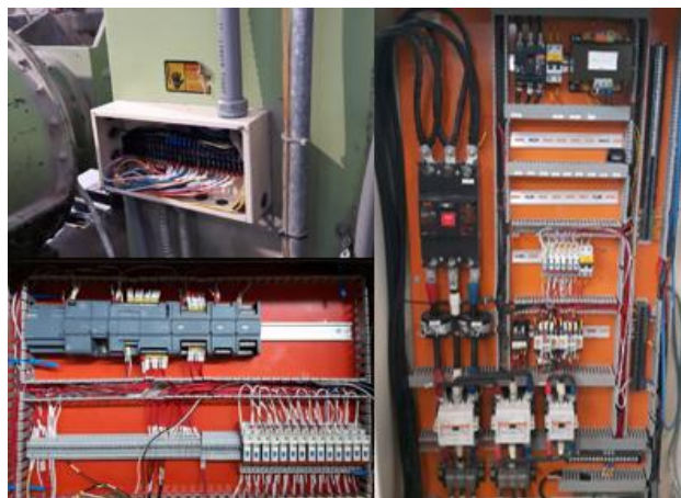
Fig. N° 32: Conexión de equipos de control Fuente: Automatización de mezcladora YT04
