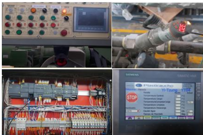
Fig. N° 33: Equipos instalados y funcionando Fuente: Automatización de mezcladora YT04
