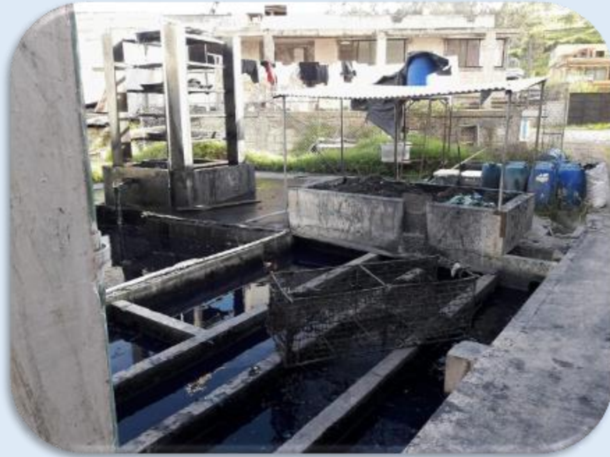
Tanque de almacenamiento del agua residual
