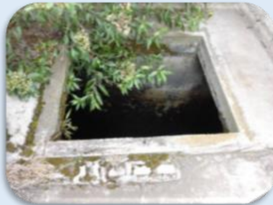
Tanque reservorio N°3
