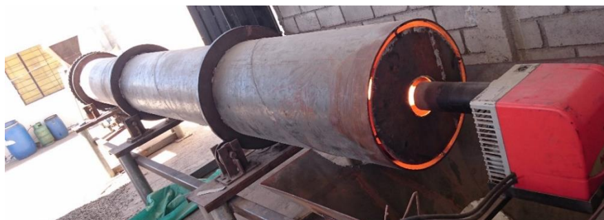
Figura 3. 50. Quemador en funcionamiento.
