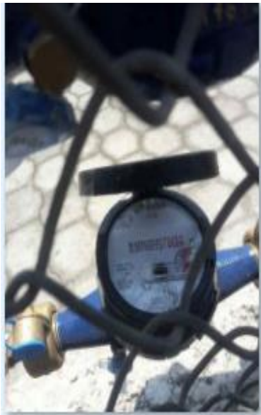
Medidor de agua potable que utiliza la lavadora
