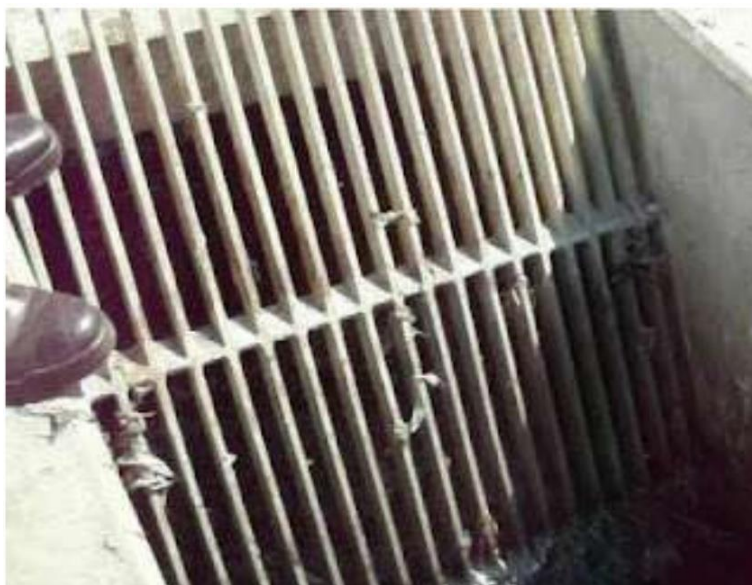
Foto 1: Rejillas con aberturas entre 4 y 8 cm
