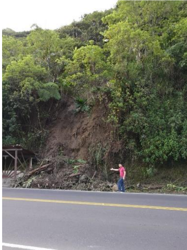
Figura N°. 61: Ubicación del sector afectado vía Baños-Puyo
