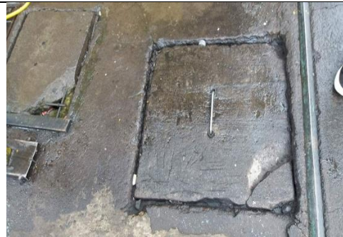
FIGURA 13. Pozo de Revisión
