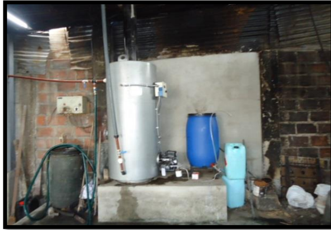
Imagen 13. Calentador de agua Fuente: Autor
