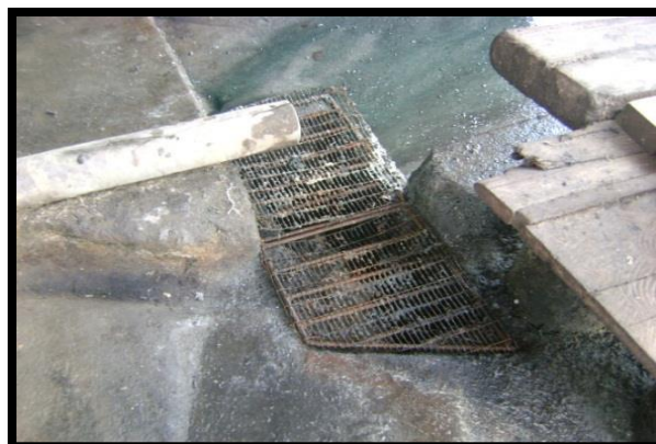
Imagen 14. Sistema de rejillas Fuente: Autor
