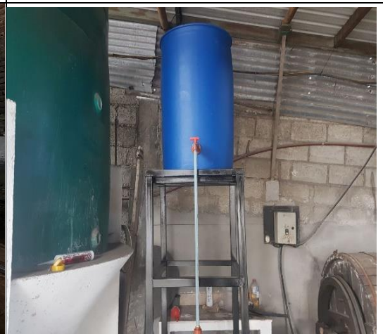
Imagen 27. Tanque con el sistema de tubería
