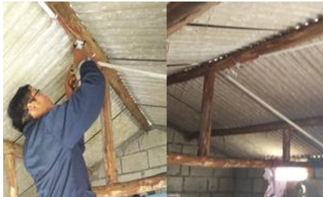
Figura 57: Instalación eléctrica en el interior de la vivienda
