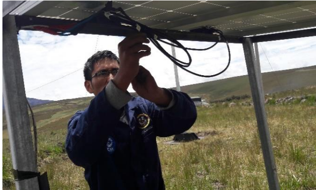
Figura 56: Conexión eléctrica de los módulos
