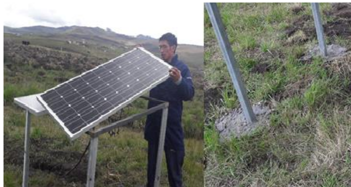
Figura 55: Ubicación de los módulos fotovoltaicos
