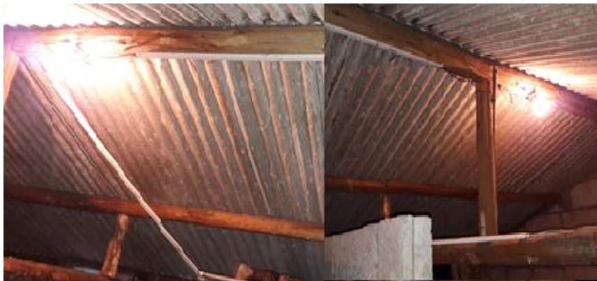
Figura 64: Prueba de funcionamiento de los focos.
