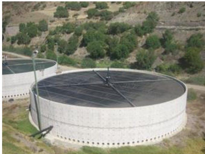
FIGURA 8 VISTA GENERAL DE UN FILTRO PERCOLADOR
