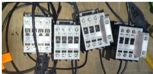
Figura 3. 40 Contactores G.E CL00-110V
