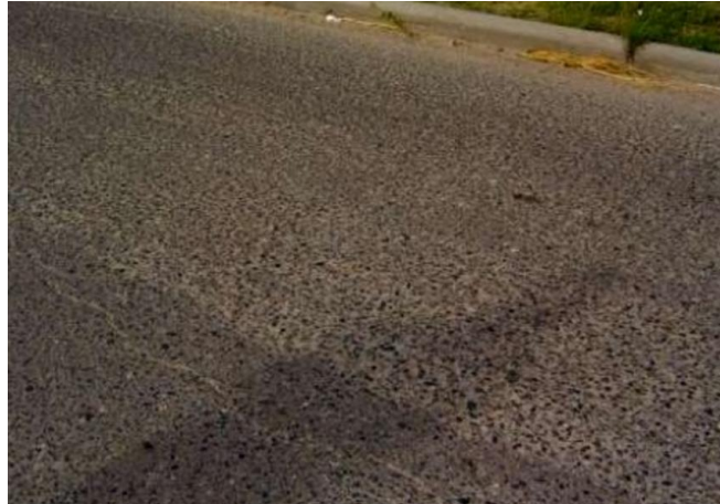
Figura 4. Desprendimiento de partículas
