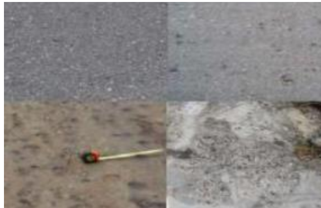
Figura 6. Falta de adherencia
