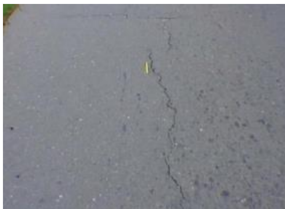
Figura 5. Fisuras y grietas longitudinales
