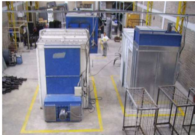
SEÑALIZACION DE AREAS DE TRABAJO
