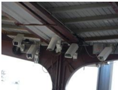
Figura 2. 2 Circuito Cerrado de Televisión
