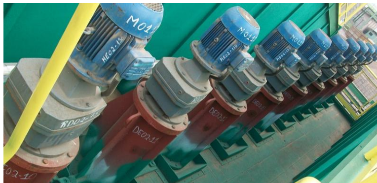
Figura 58: reductores y motores eléctricos, parte superior del difusor
