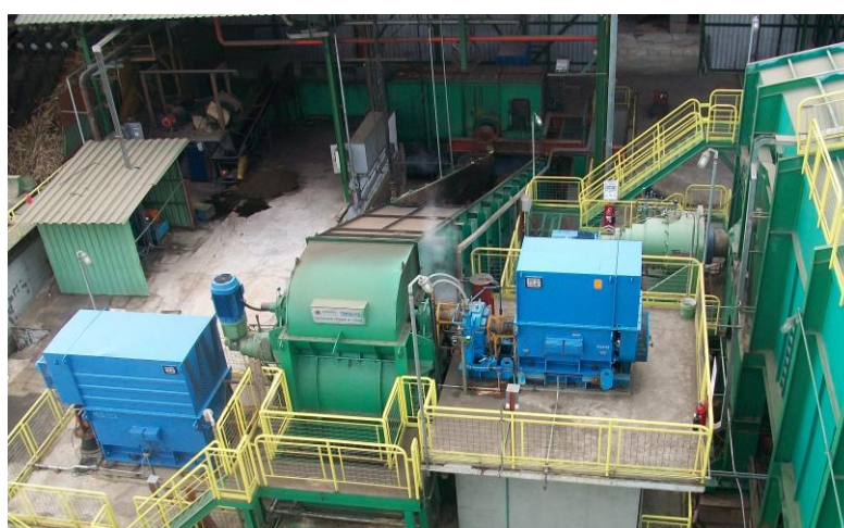
Figura 60: Componentes, motores, reductores en desfibrador y cuchillas #2
