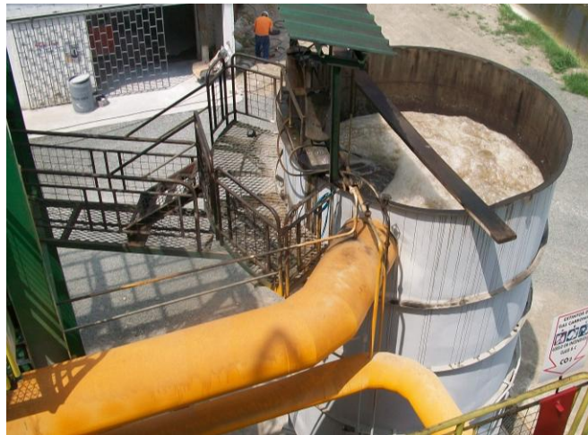
Figura 38: Tanque captador de jugo
