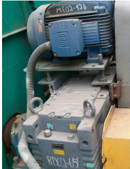
Figura 53: Motor eléctrico, reductor, caja del conductor #3
