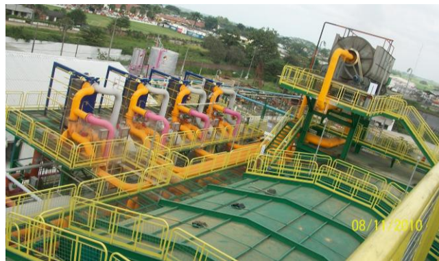
Figura 35: Parte superior de la cámara de extracción de jugo con las bombas, y calentadores de agua Fuente: Compañía azucarera Valdez
