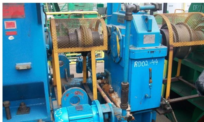
Figura 55: Motor eléctrico y reductores del desfibrador
