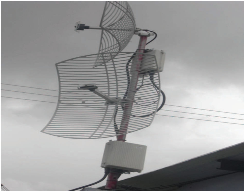
Fig.6.1. Antena de transmisión microondas de la Subestación Atocha del anillo 69kV de la EEASA.
