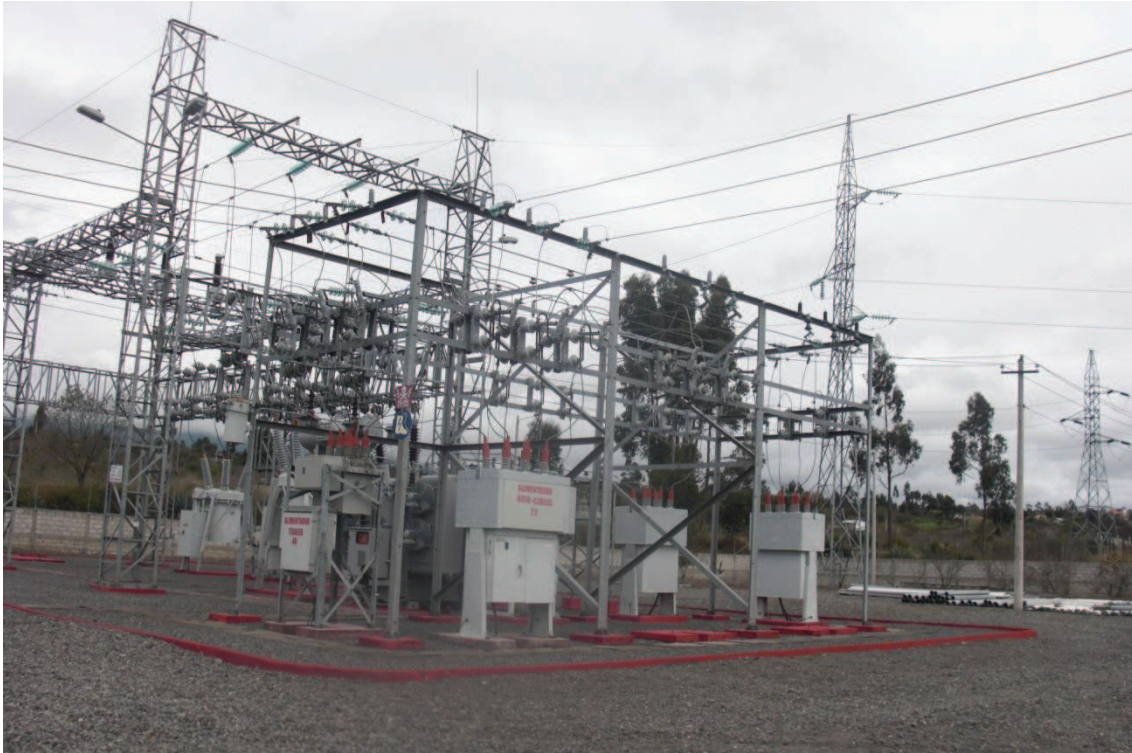
Fig. 2.3.5 Vista de una sub-estación de distribución de la EEASA
