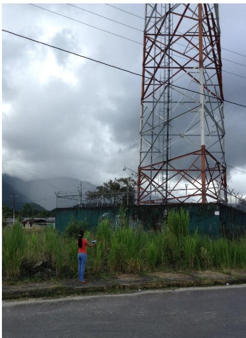
Fig. 4. 15 Medición a 10m de estación base
