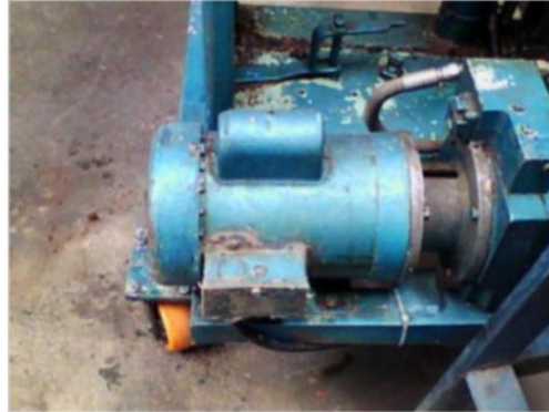
Figura 4.16 Motor bomba del elevador.
