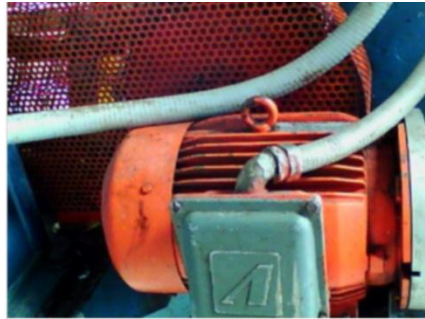
Figura 4.6 Motor de la escurridora. Fuente: (SOGUAR S.A.)
