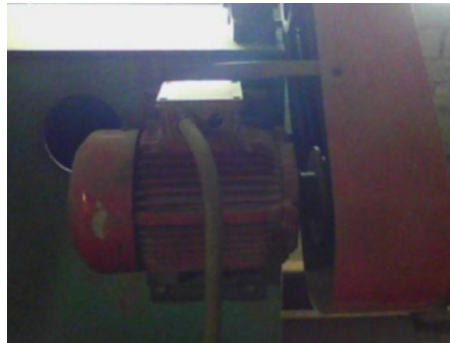
Figura 4.28 Motor del ventilador principal. Fuente: (SOGUAR S.A.)
