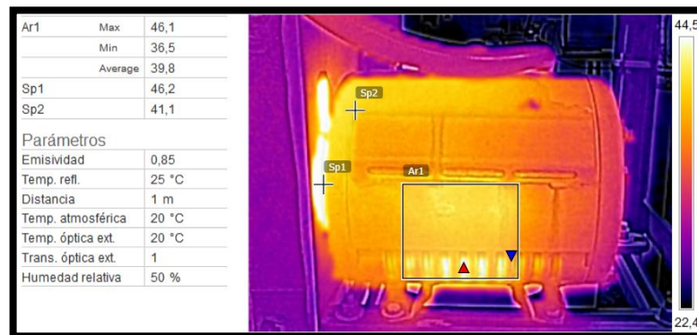
Figura 4.19 Imagen termográfica de la carcasa del motor molino húmedo.
