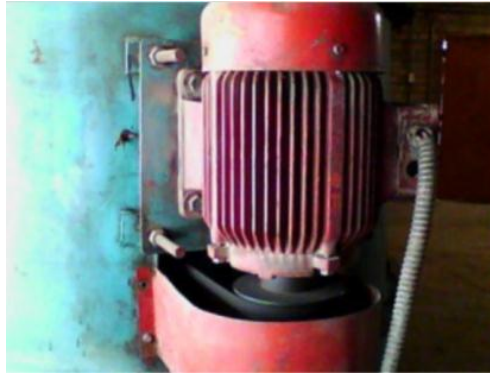
Figura 4.26 Motor del ventilador principal. Fuente: (SOGUAR S.A.)
