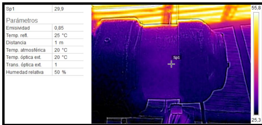
Figura 4.15 Imagen termográfica de la carcasa del motor del elevador. Fuente: (SOGUAR S.A.)
