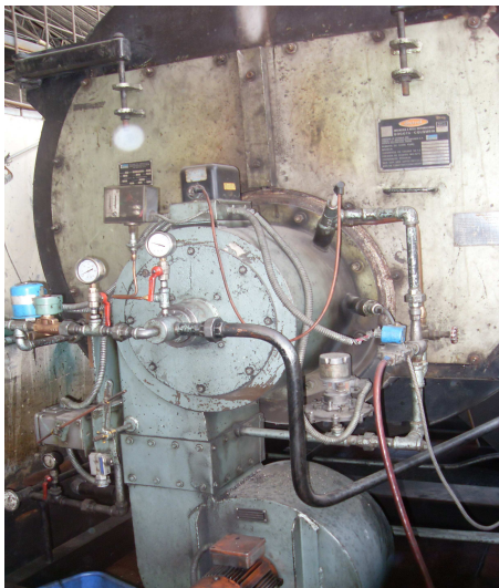
Figura N° 6: Caldera vista frontal
