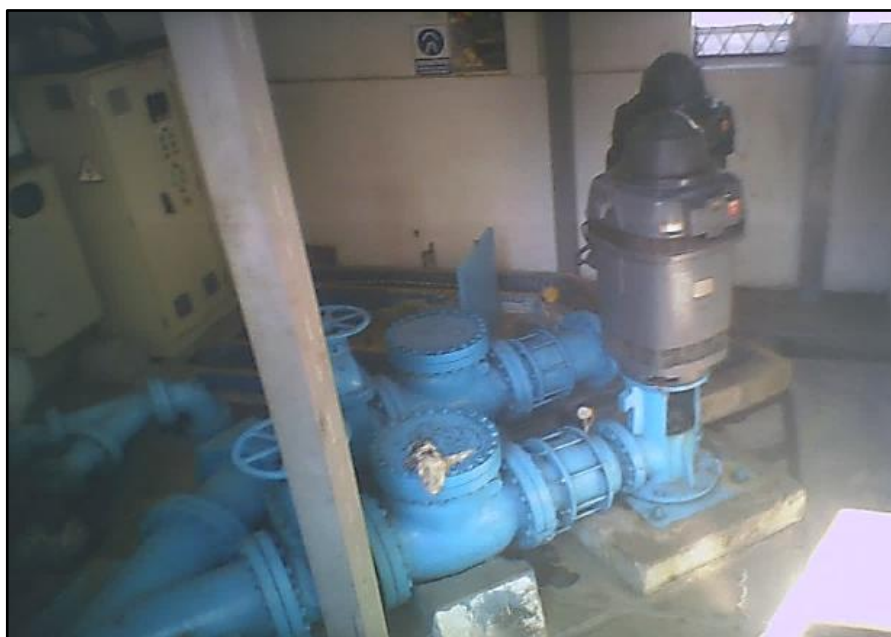
Figura 18: Cuarto de Máquinas en la estación de bombeo Miraflores
