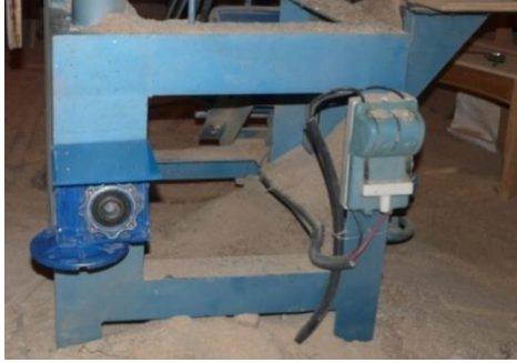
Figura 6.2. Instalación del reductor sin fin corona
