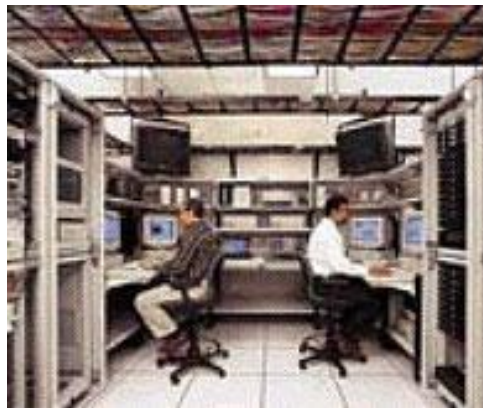
Figura 2.27. Cuarto de Equipos.
