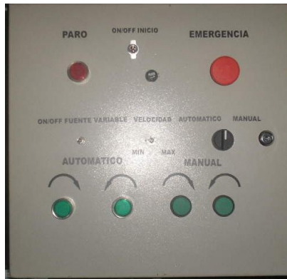
Figura N° A.1 Panel de control
