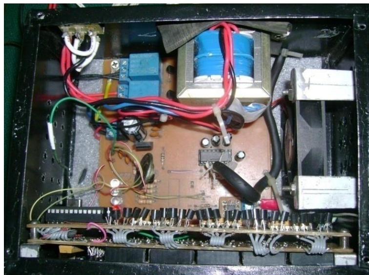
Gráfico N° 63. Sistema de Control Eléctrico Elaborado por: Carlos Calderón
