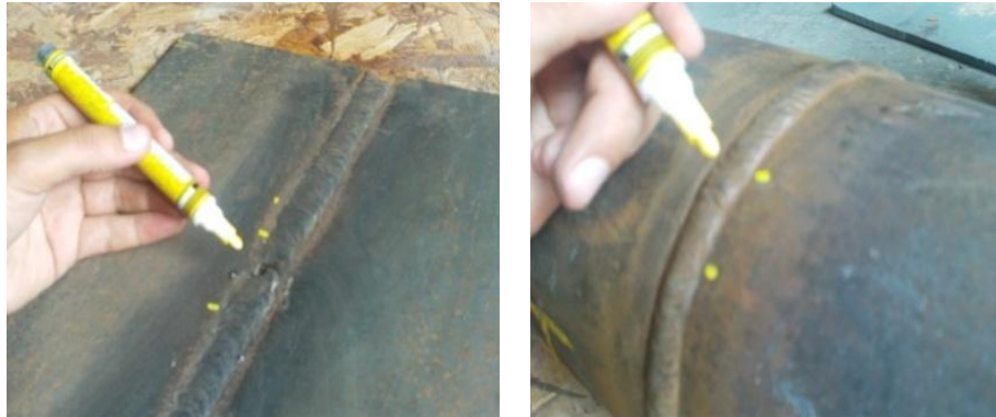
Gráfico N°6.20 Ubicación de posible defecto.
