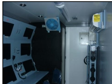
Fig. 12: Detalle de equipos en interior de furgón
