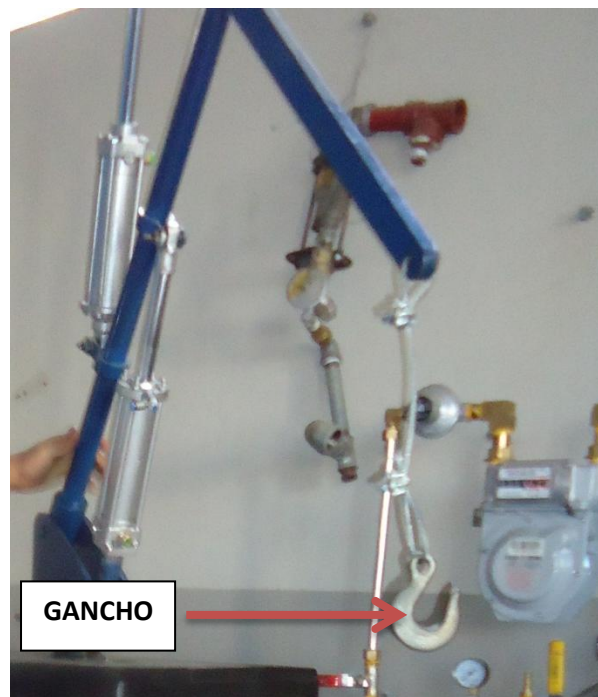
IMAGEN 4.4 Estado del elemento terminal. 34
