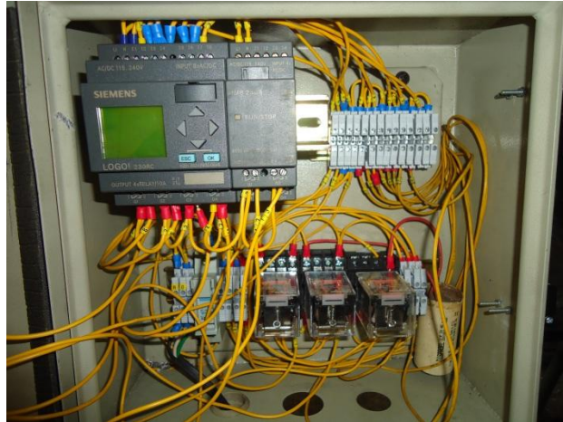
IMAGEN 6.11.- Conexión del circuito eléctrico y de control. 60
