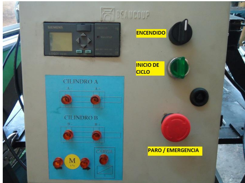
IMAGEN 6.12.- Caja del circuito de control. 62
