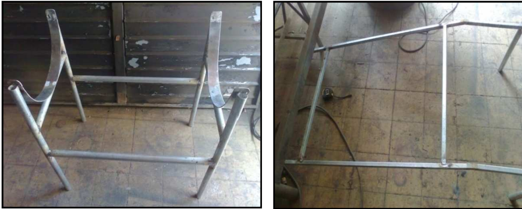
Figura 6.22 Estructuras de soporte del tanque de almacenamiento y del panel, respectivamente.
